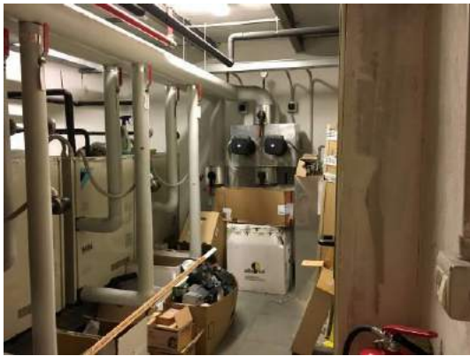
Vista interna - Locale tecnico
