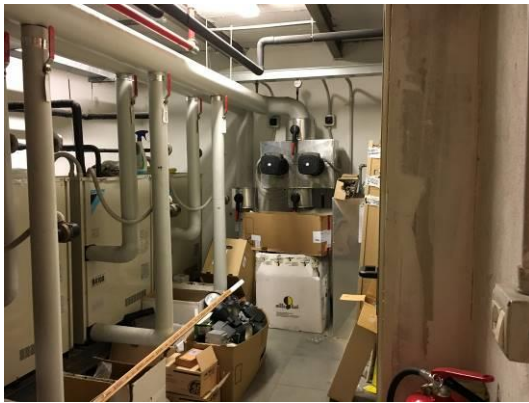
Vista interna - Locale tecnico
